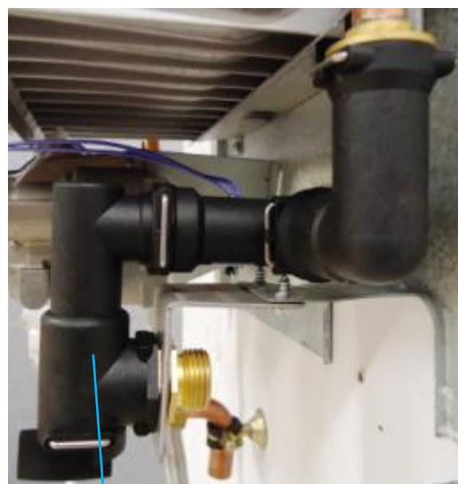
Вход холодной воды и фильтр
